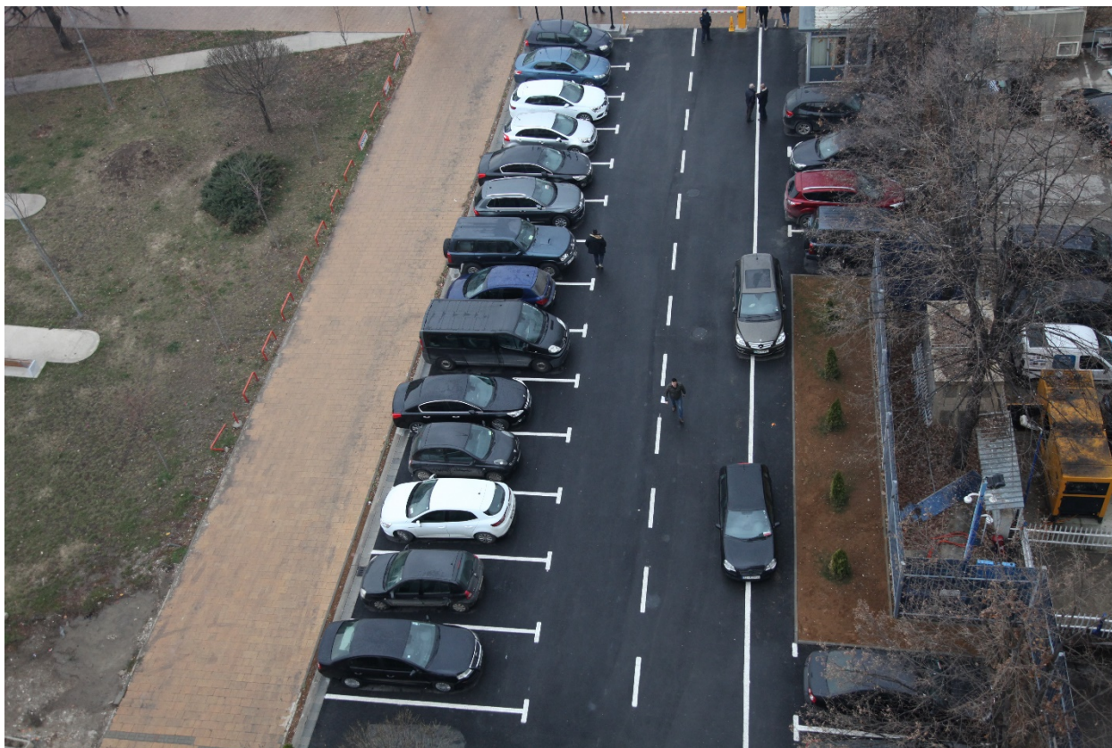
Prishtinë, gusht 2018 - Rregullimi (asfaltimi) i parkingut para objektit të Ministrisë së Punëve të Jashtme nga MAP.
